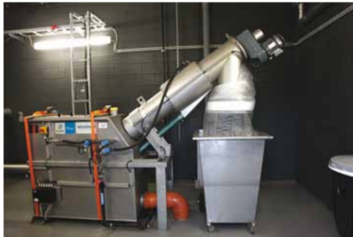
Purgla mehhaanilise puhastuse võre.
